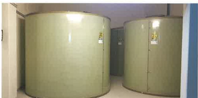
Vier Haase-Dieseltanks für Notstromaggregate mit insgesamt 66.000 Liter Inhalt
